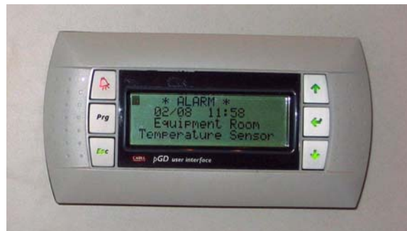
HVAC PGD Display
