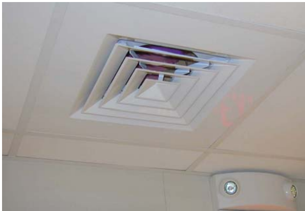
HVAC Vent Discharge
